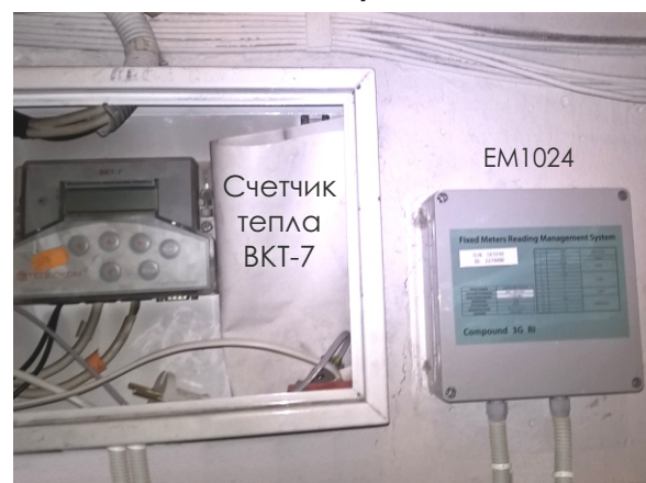
Пример монтажа при подключении EM1024 к теплосчетчику ВКТ-7:
